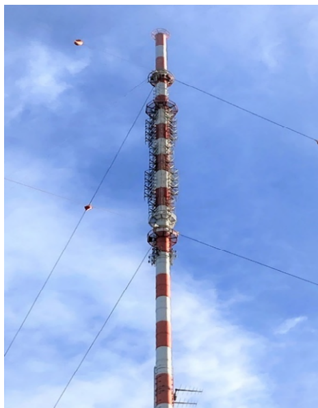
Bild 2, links: Die DAB+ Antenne befindet sich an der Spitze im GFK Zylinder
